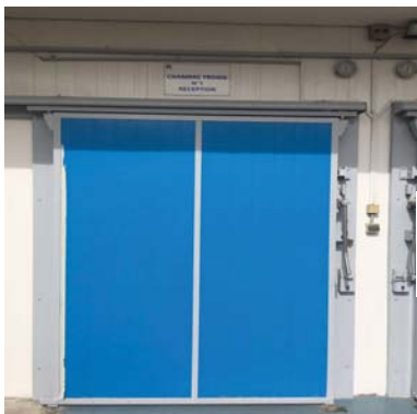
Chambre froide N°1 Zone de réception
