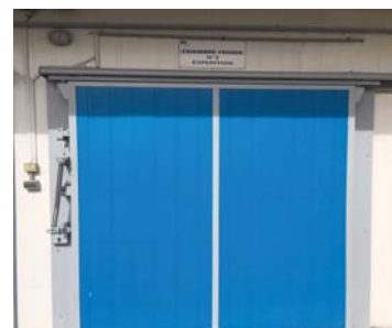
Chambre froide N°2 Zone d'expédition
