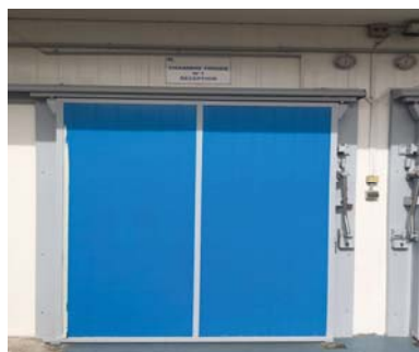
Chambre froide N°1 Zone de réception
